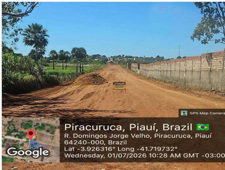
Foto 67 – Rua Domingos Jorge Velho em processo de terraplenagem, com solo revolvido, material solto e ausência de dispositivos de drenagem. Coordenadas: -3.926316, -41.719732. Fonte: Acervo técnico da RN Engenharia, levantamento de campo georreferenciado realizado em julho de 2026.
