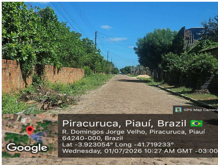
Foto 69 – Rua Domingos Jorge Velho com pavimento irregular, vegetação e sedimentos acumulados junto ao bordo da via. Coordenadas: -3.923054, -41.719233.
