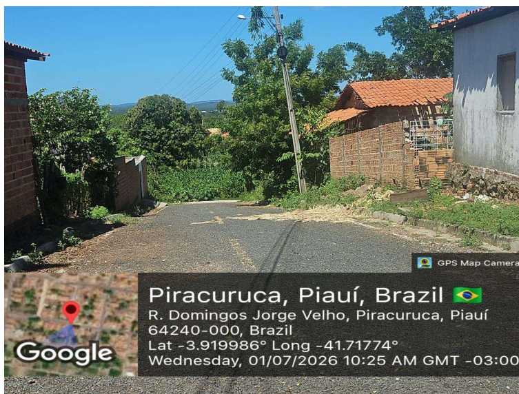
Foto 61 – Rua Domingos Jorge Velho com pavimento em pedras, vegetação avançando sobre o bordo e ausência de sarjetas contínuas. Coordenadas: -3.919986, -41.717740.
