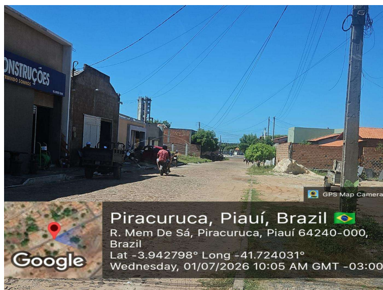
Foto 13 – Trecho de uso misto na Rua Mem de Sá, com superfície em solo exposto, ausência de meio-fio contínuo e inexistência aparente de microdrenagem. Coordenadas: -3.942798, -41.724031.
