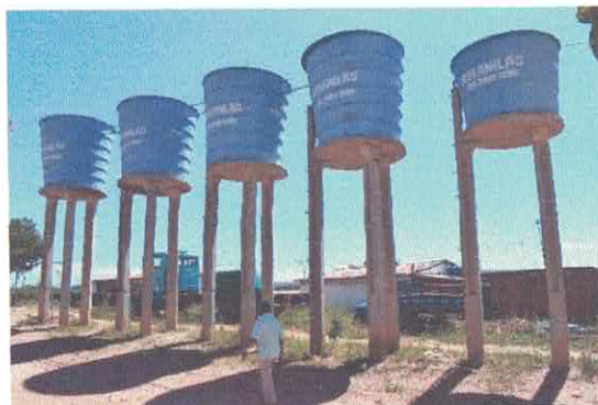
Foto 2 - Reservatórios Elevados 400m 2 do Pov. Curralinho em Simões-PI
