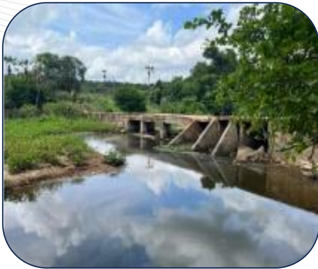
Figura 45: Interdição e Recuperação da Ponte
