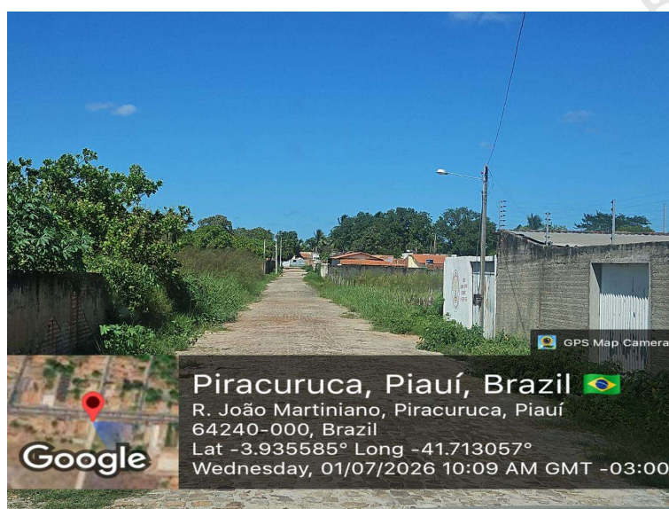
Foto 24 – Rua João Martins sem pavimentação, com vegetação nas margens, superfície irregular e ausência de estruturas de drenagem. Coordenadas: -3.935585, -41.713057.
