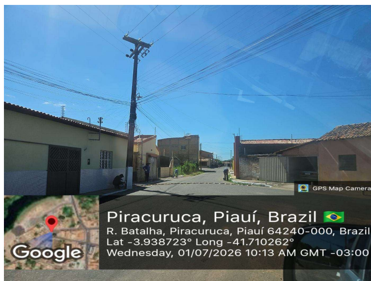
Foto 39 – Trecho pavimentado da Rua Batalha com bordos irregulares, ausência de sarjeta contínua e escoamento direcionado pela própria pista. Coordenadas: -3.938723, -41.710262. Fonte: Acervo técnico da RN Engenharia, levantamento de campo georreferenciado realizado em julho de 2026.
