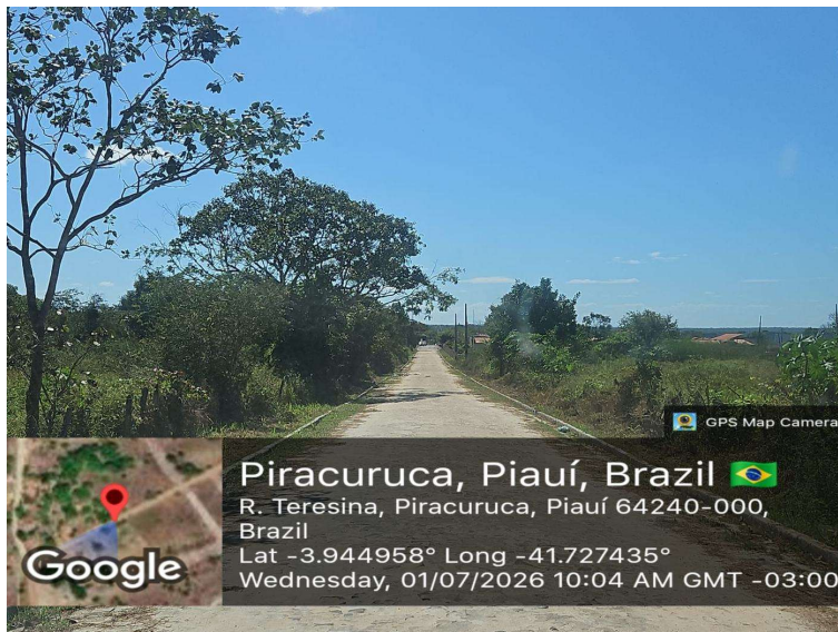
Foto 11 – Via periférica não pavimentada, com leito em solo exposto, margens vegetadas e ausência de sarjetas ou dispositivos de captação de águas pluviais. Coordenadas: -3.944958, -41.727435.
