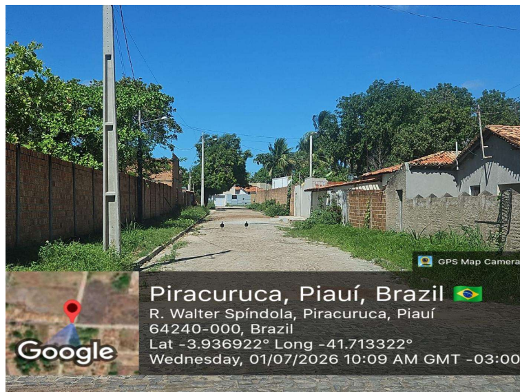
Foto 25 – Rua Walter Spíndola sem pavimentação, com leito irregular e inexistência aparente de sarjetas, bueiros ou bocas de lobo. Coordenadas: -3.936922, -41.713322.
