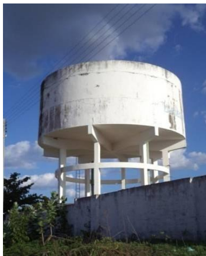
Foto 13: Reservatório da AGESPISA que abastece a Zona Urbana de Piracuruca.
